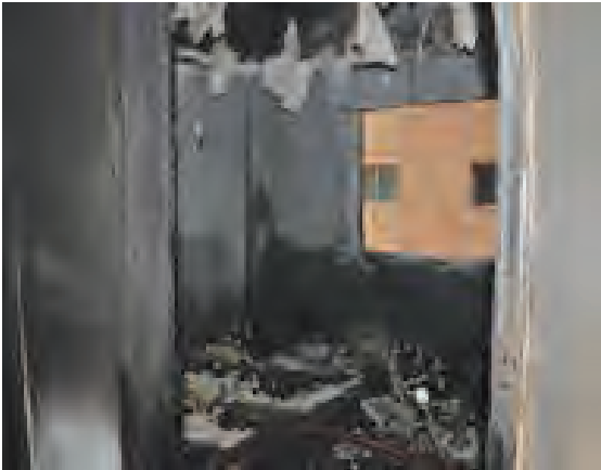
الشقة بعد الحريق
