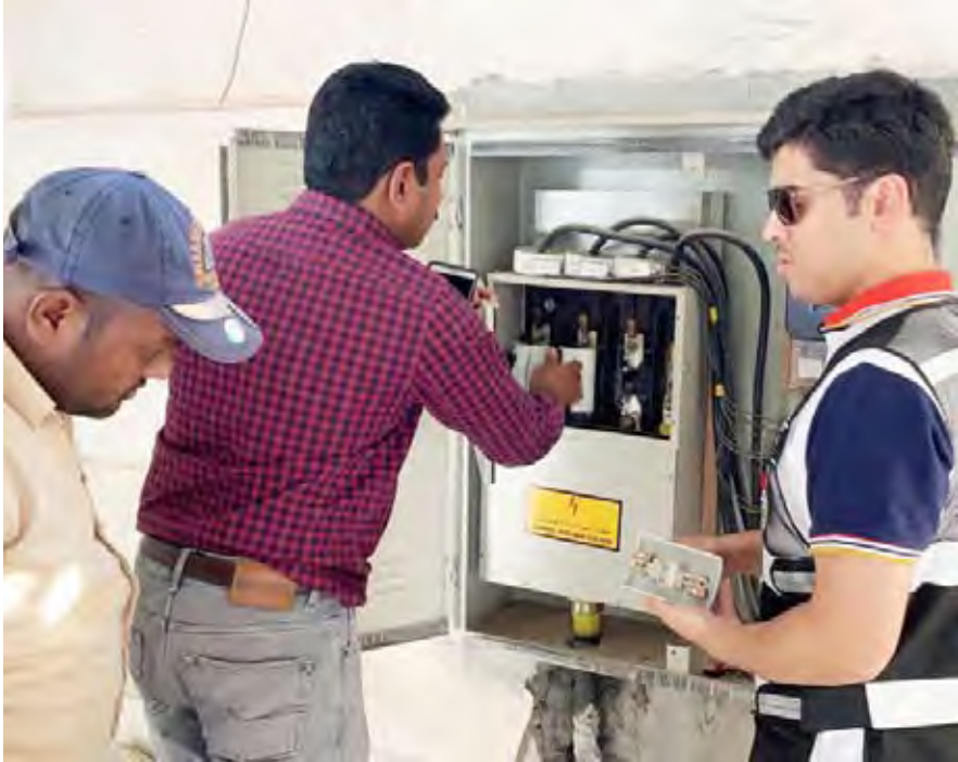
قطع التيار الكهربائي
