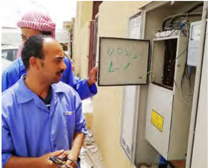
قطع التيار الكهربائي
