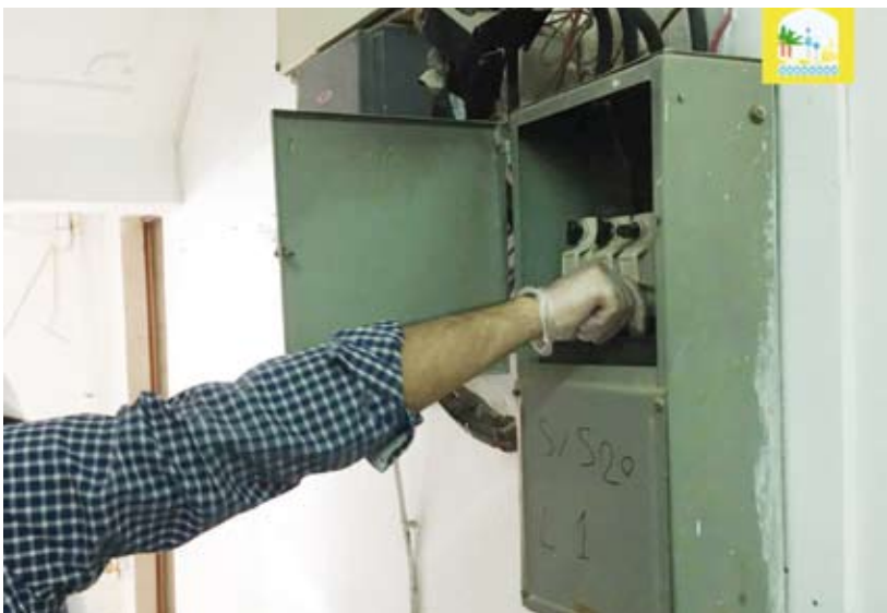
قطع التيار الكهربائي
