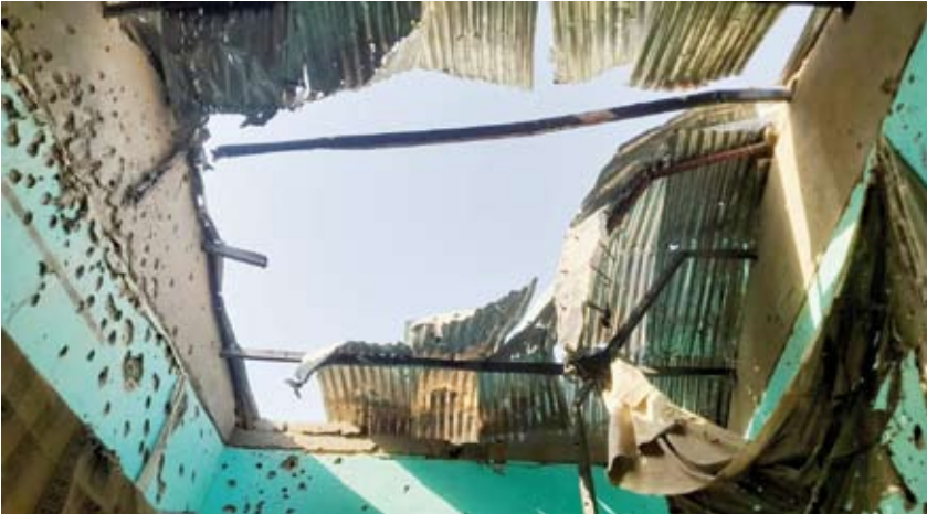
سقف متضرر بشظايا الحصف
