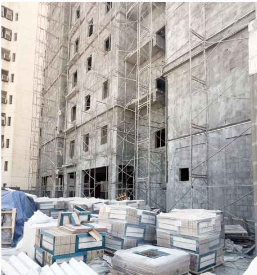
أحد المباني المخالفة
